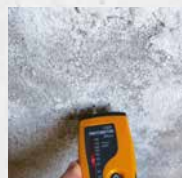
voor met zouten belast metselwerk
