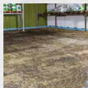
niet dampdicht beton
